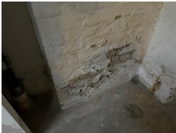
Äldre fuktgenomslag, torrt
