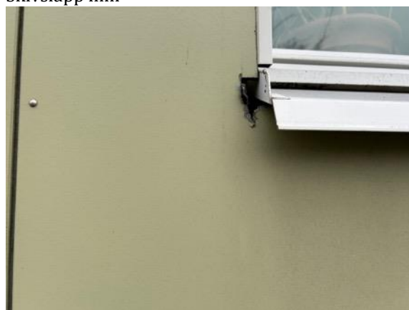
Otäteter kring fönsterbleck
