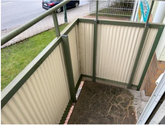
Krympsprickor i ovanyta balkongplatta
