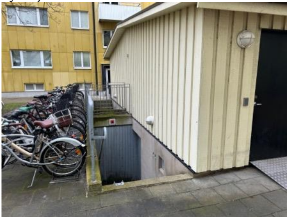
Skyddsrum under miljöhus
