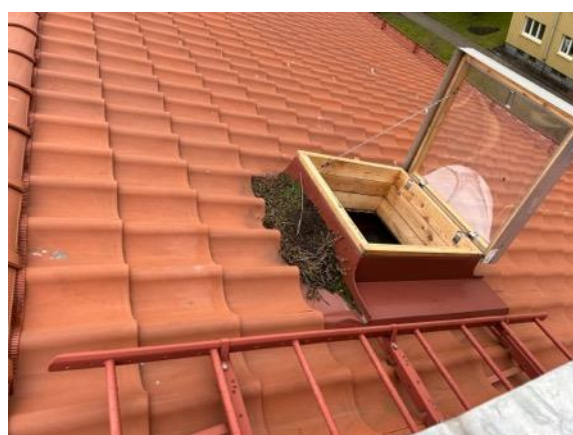
Uppstigningslucka saknar skyddsräcke. Fågelbo.
