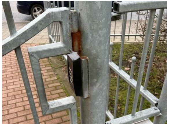
Rostangrepp gångjärn till grind
