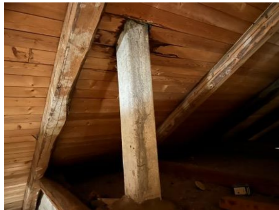
Tidigare, ej pågående, läckage kring eternitkanal.
