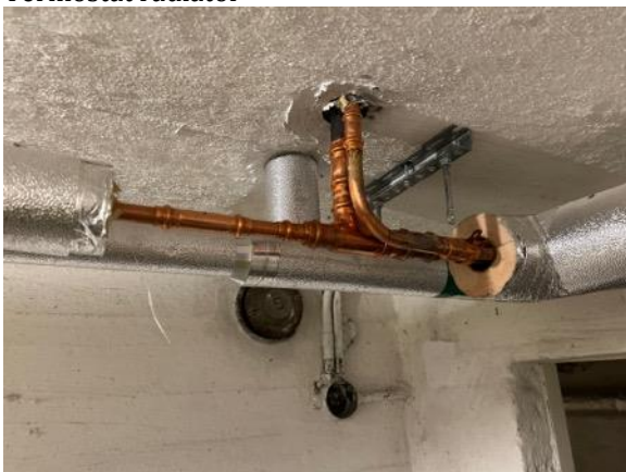
Oisolerat varmvattenstråk i f.d. skyddsrum
