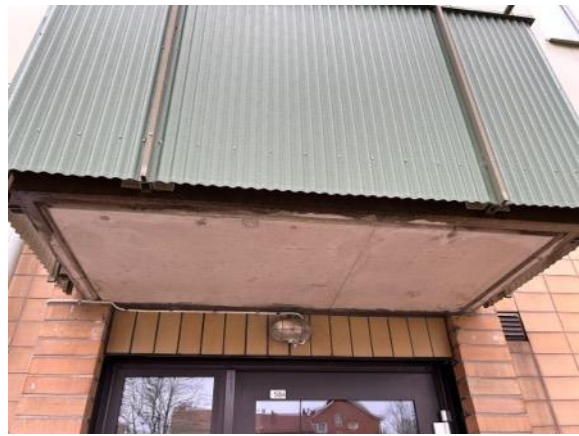
Inga sprickor, genomslag undersida balkongplatta
