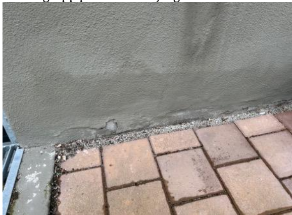
Färg/putssläpp på grundmur (före dränarbete?)
