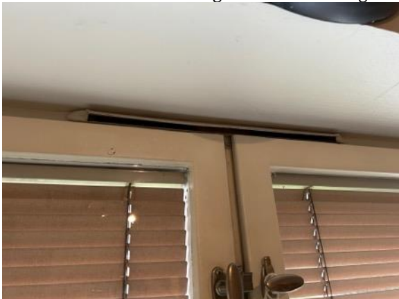
Lägenhetsfönster med tilluftsventil
