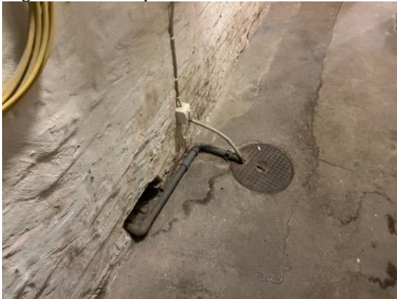
Kabel till dränpump skaderisk
