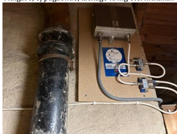
Äldre antennutrustning ej i bruk
